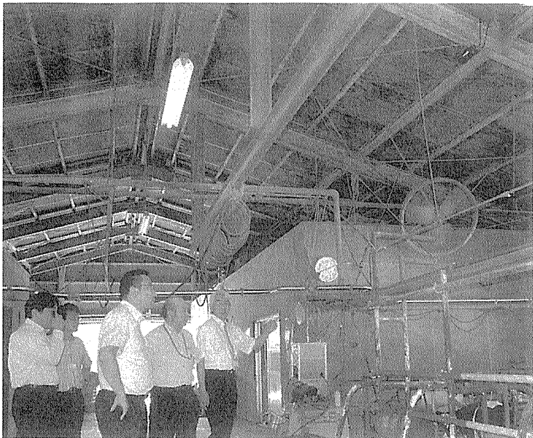
牛の行動監視システムのカメラが天井に設置された牛舎。鯉洲学園農業栄養専門学校
